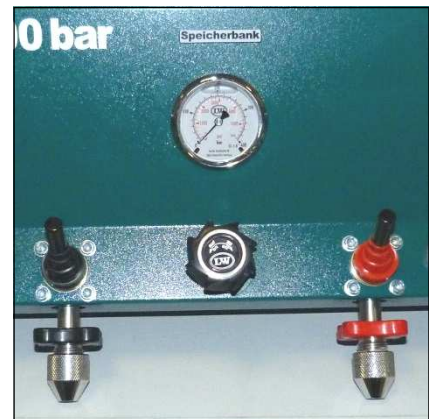
Abb. 1 - Drehventil und Manometer
